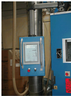
Visualisierung und Bedienung der Verteilsteuerung eines Silolagers mit Touchpanel.
